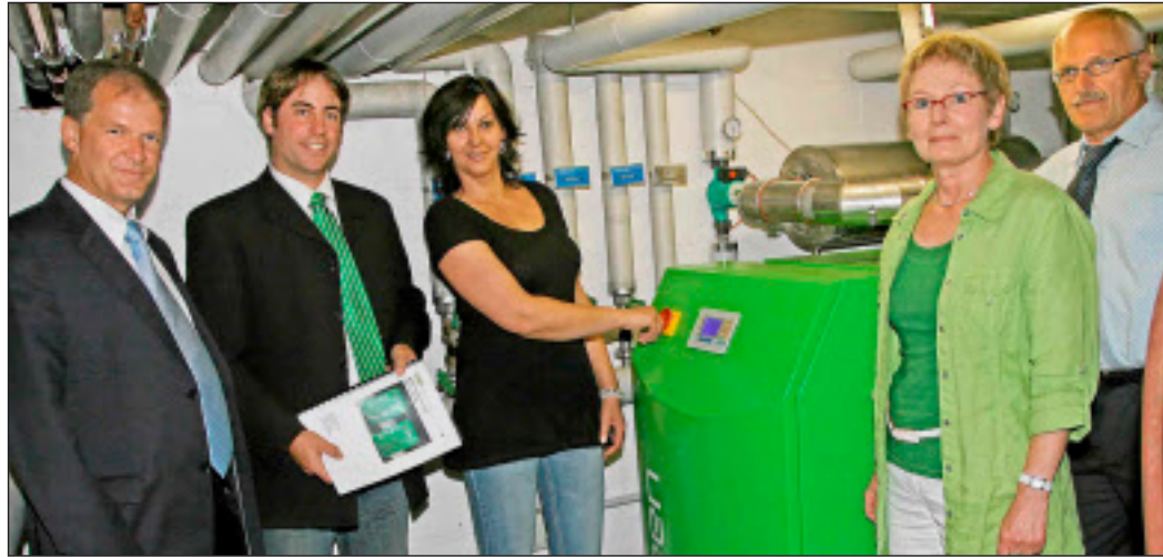
Nehmen das Blockheizkraftwerk in Betrieb: (v. l.): Jürgen Mock, Thomas Grahl, Franzl Ruggera, Brigitte Fickler und Helmut Unzeitig. (Foto: Pöllnitz)
