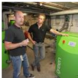
Soll sich rechnen: Von dem Minikraftwerk sind Hans-Jürgen Eckel und Lars Höfer (r.) überzeugt. (Fotos: Schmitz)
